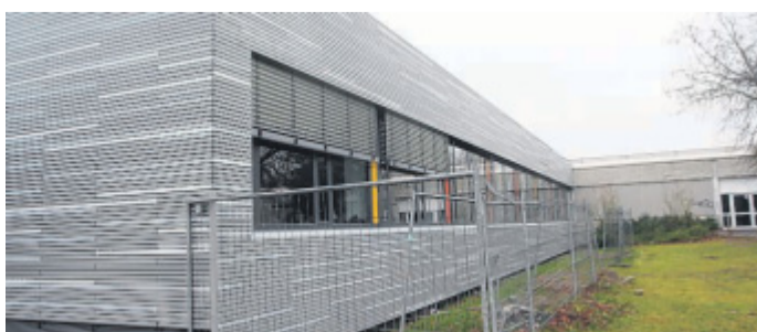
Gut gelöst: Vor die alten Betonmauern wird eine Fassade mit Aluminiumprofilen gehängt; dadurch wird zugleich gedämmt.
